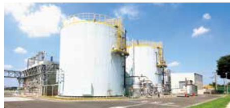
コープのお店などから出る生ごみを使って発電するバイオガス発電所 (ニューエナジーふじみ野株式会社)
